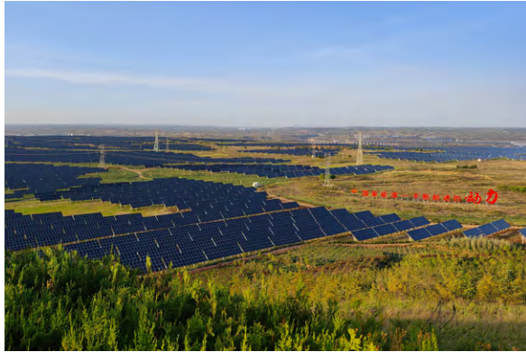
内蒙古白音提布光储电站
